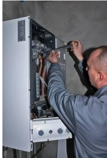
Modernizacja instalacji grzewczej może zwiększyć efektywność systemu.
