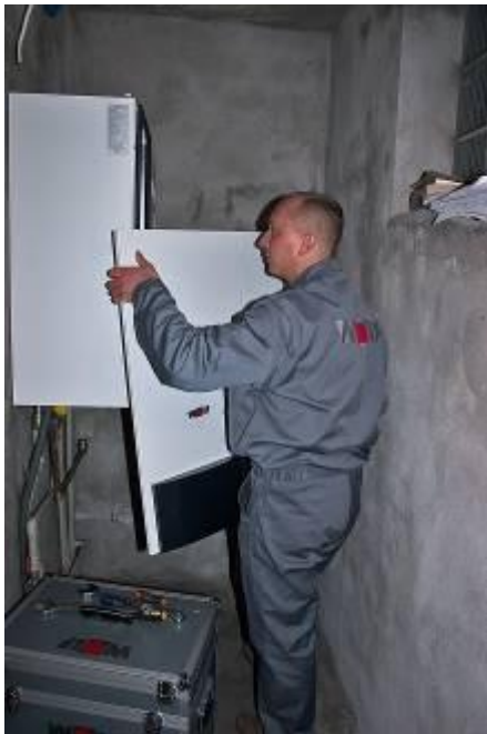
Instalatorzy firmy Wolf-Technika Grzewcza sp. z o.o. to wieloletni praktycy, którzy w swojej pracy wykorzystują najświeższą wiedzę z zakresu technik instalacyjnych. fot. Wolf- Technika Grzewcza sp. z o.o
