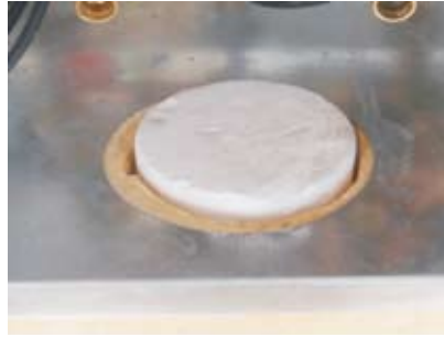
Isolierdeckel über Opferanode entfernen
